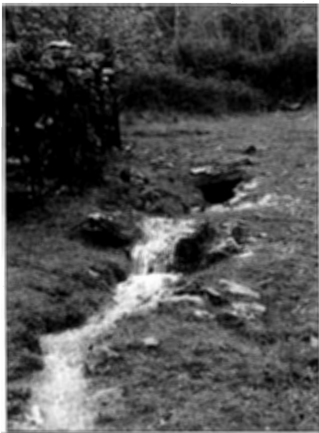
Foto 7. Restos de alcantarillado.
